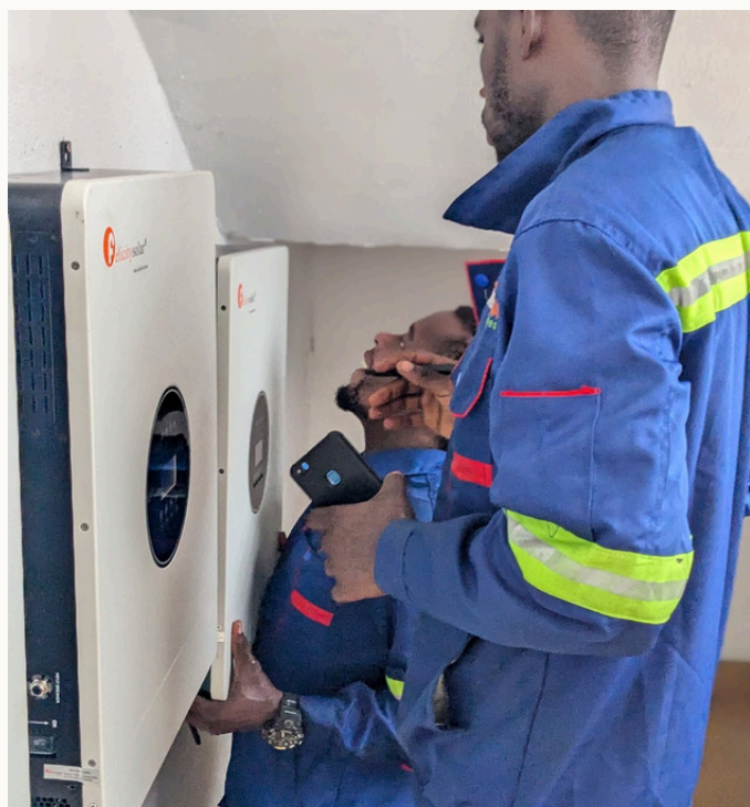
Installation hybride du site STIHL Central Africa à Douala. SmartSana Energies.
